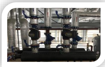
Rozdzielacz ciepła odpadowego
